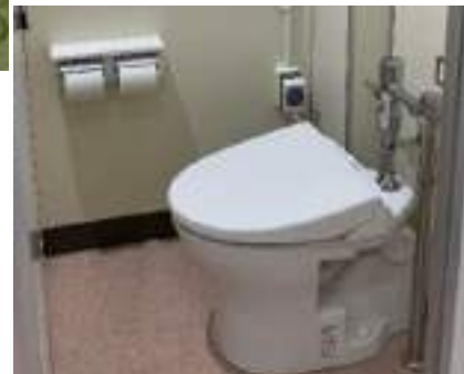
【学校トイレの環境改善の例】
